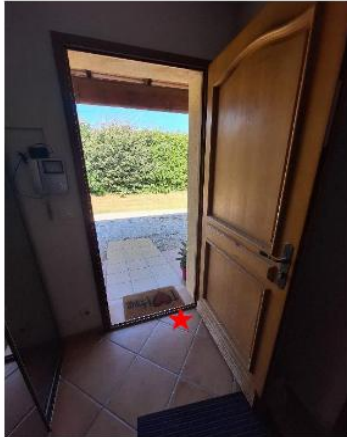
Porte d'entrée avec seuil extérieur difficile à franchir
